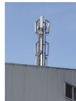
Mobilfunkbasisstation Foto: IMST GmbH
